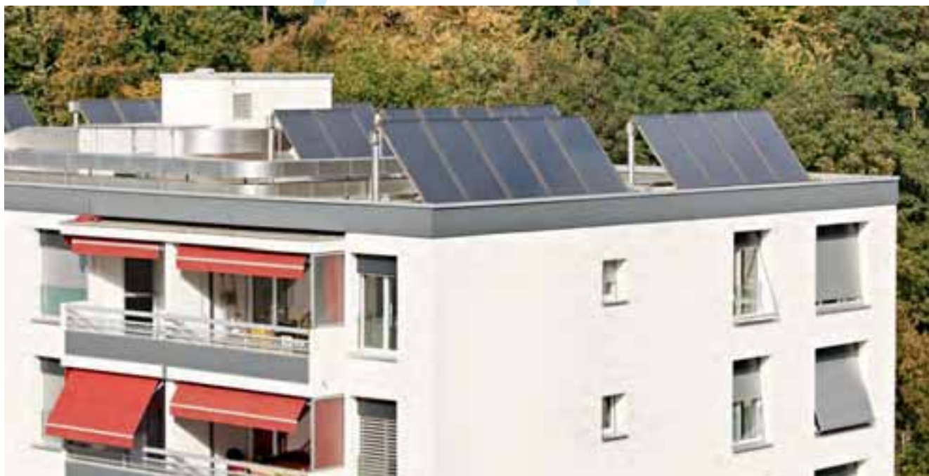
Pierrefleur, panneaux solaires
